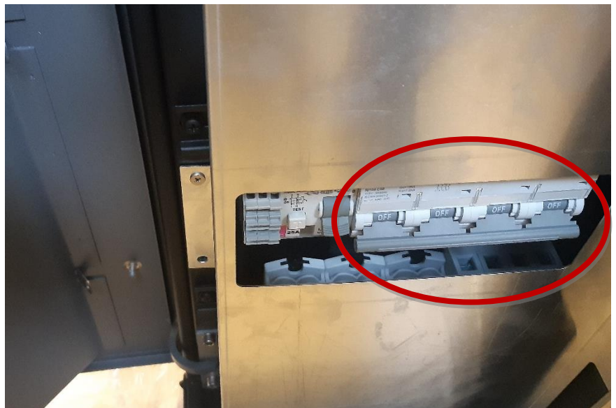
Figura 44: O disjuntor principal pode ser utilizado para reiniciar a estação de carregamento
