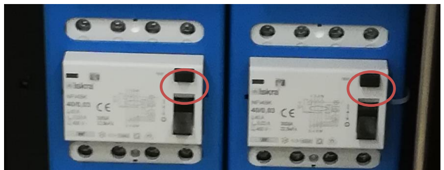
Figura 44: pulsanti di test RCD
