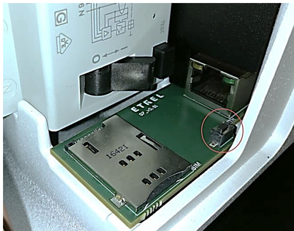
Figur 43: Återställningsknapp inuti underhållsöppningen
