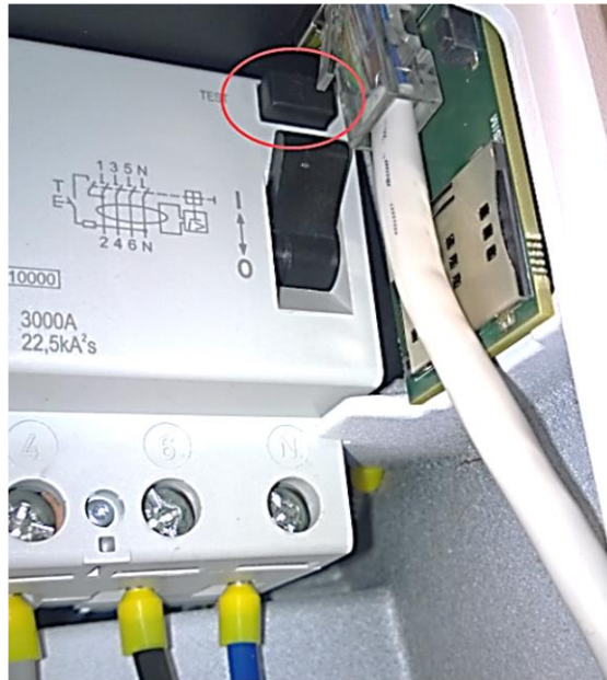
Figura 43: pulsante del test RCD
