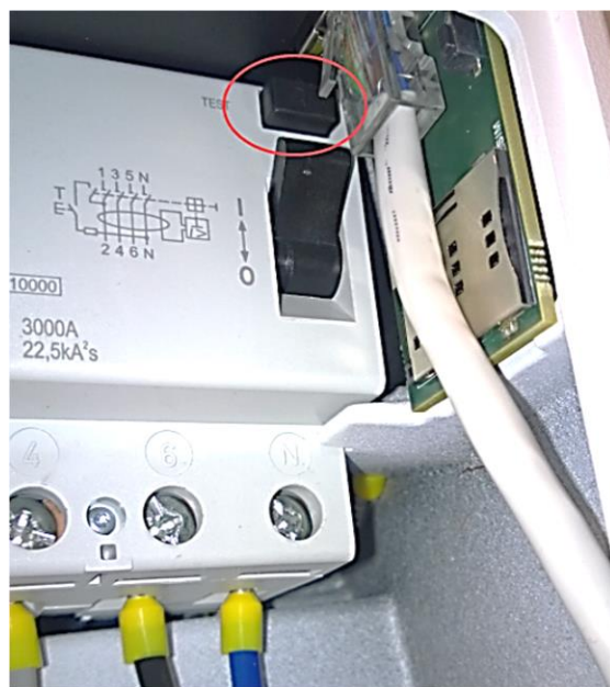
Abbildung 43: Prüftaste des Fehlerstromschutzschalters (RCD)
